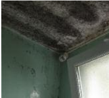
Présence de moisissures sur un plafond
