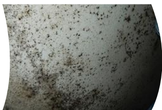
Moisissures dans un logement Visite CMEI - Août 2018 © Atmo Hauts-de-France
